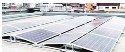
完成した発電所
